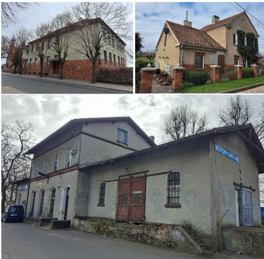
Rycina 27 Przykłady budynków w złym stanie technicznym na terenie Kotlina
