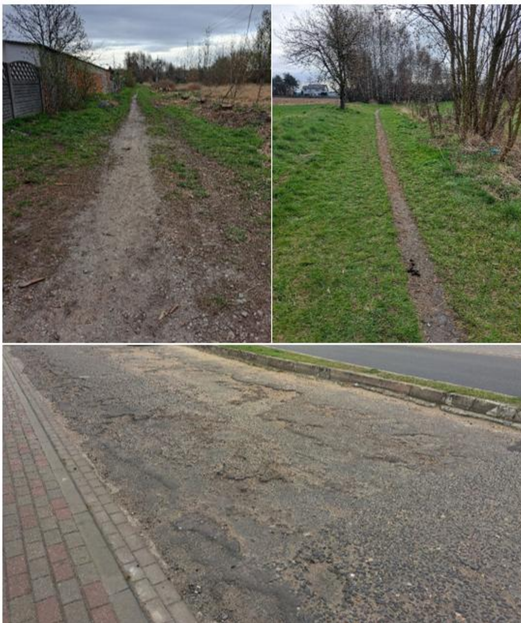
Rycina 22 Przykład ciągów komunikacyjnych w złym stanie technicznym na terenie Kotlina
